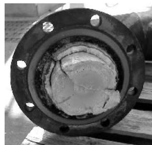
Fig. 1 Linha de vent obstruída
